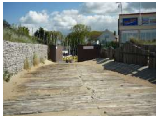
Brèche dans le cordon dunaire modélisée pour réaliser l'aléa de référence – 2015
